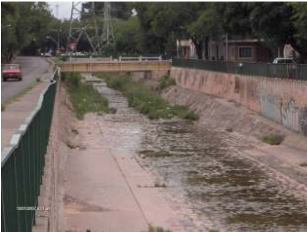
Figura 255: Tramo sur – norte, al oeste del Barrio Bombal. Puede apreciarse el escurrimiento de agua, que es permanente y favorece el crecimiento de vegetación entre las juntas de hormigón, la junta tomada de las piedras y el embanque que, poco a poco, se va acumulando por el efecto de intercepción de la vegetación.
