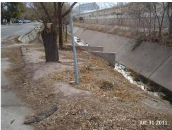
Figura 284: Sección Trapezoidal aguas arriba del Acceso Norte, con el desagüe pluvial del barrio aldeaño.
