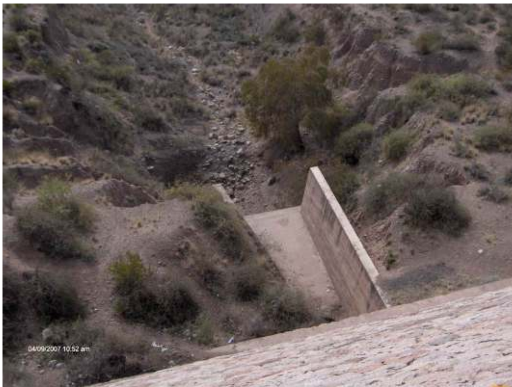
Figura 37: Detalle de la salida del túnel de evacuación de la torreta de margen derecha.
