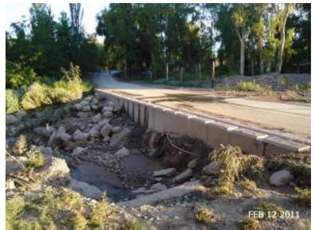
Figura 417: Vista del Badén de El Challao. La erosión aguas abajo ha progresado desde su reconstrucción en febrero de 2007.
