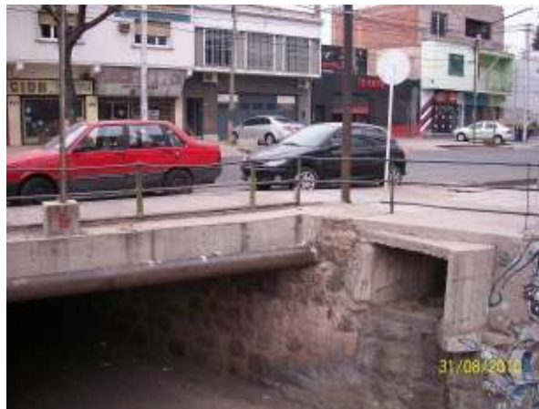
Figura 377: Descarga del sistema colector pluvial de calle San Juan hacia el Zanjón Frías,
