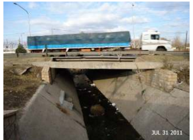
Figura 285: Sección trapezoidal y puente doble del Acceso Norte, aguas arriba del Barrio UJEMVI.
