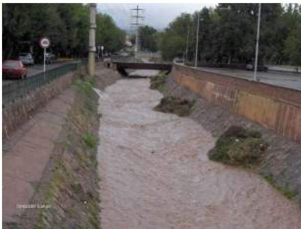
Figura 251: Descarga aluvional moderada. El cauce presenta montículos amontonados luego de un trabajo de limpieza, desembanque y desmalezado realizado por administración. Puede observarse sobre la margen derecha, una de las innumerables descargas proveniente de las acequias urbanas que, poco a poco, tienden a saturar las canalizaciones matrices, tanto con agua, como con basura. La tormenta corresponde al día 09 de febrero de 2007.
