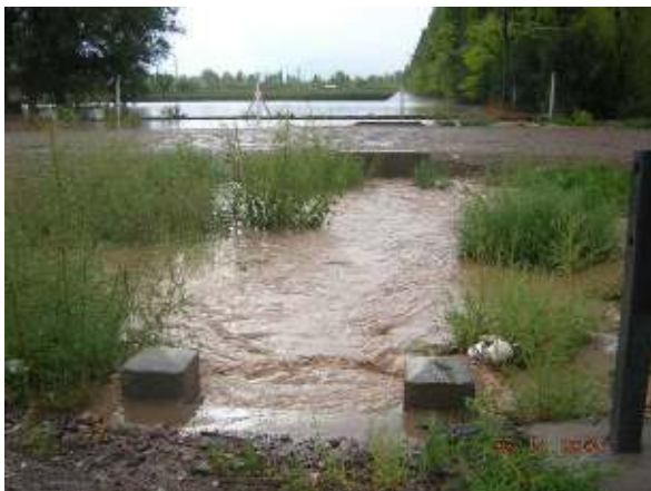
Figura 7: Saturación de los colectores pluviales debido a la incidencia del gran caudal acompañado del hielo, ramas y hojas caídas.
