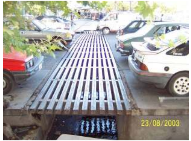
Figura 370: Reja Sistema de captación de agua pluvial en la intersección de Avenida San Martín y Zanjón Frías, ubicada perpendicular, integrada a un canal inferior que conduce el agua captada al Zanjón Frías.
