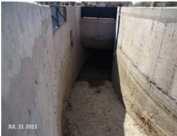
Figura 322: Sifón del Canal del Oeste en la época de corta, luego de la limpieza y desembanque.
