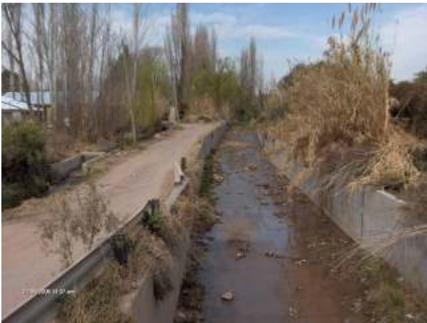
Figura 186: Detalle del Río Seco Viamonte aguas arriba de calle Matheu antes de la ejecución del tramo aguas arriba de esta I Etapa.
