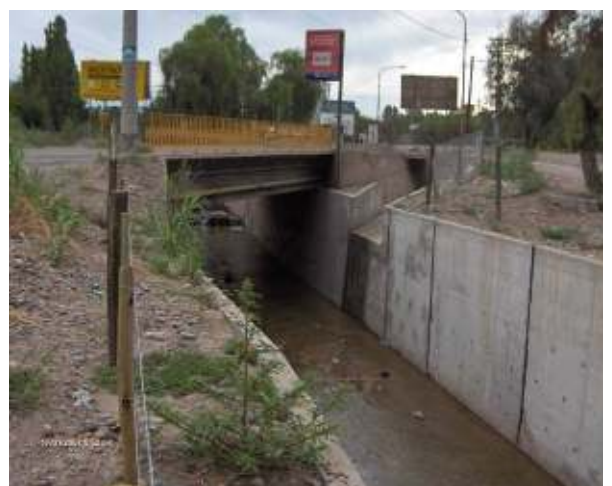
Figura 193: Puente de ruta Panamericana y desagüe del Colector del Aeroclub.
