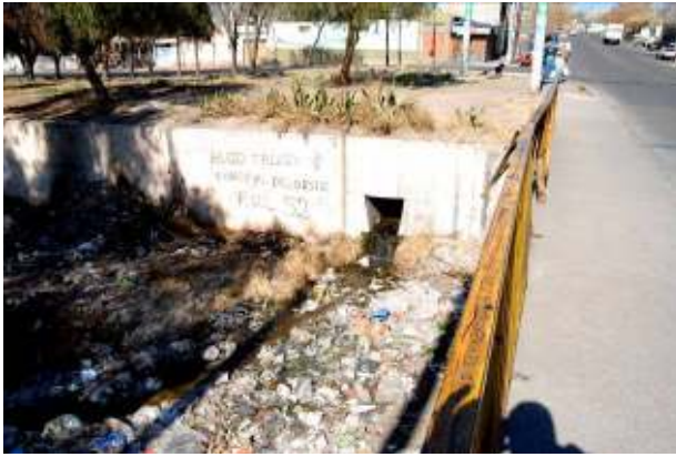
Figura 356: Desagüe de acequia que desemboca en el colector escudo, favoreciendo la contaminación existente proveniente de la basura y el desarrollo de vegetación.
