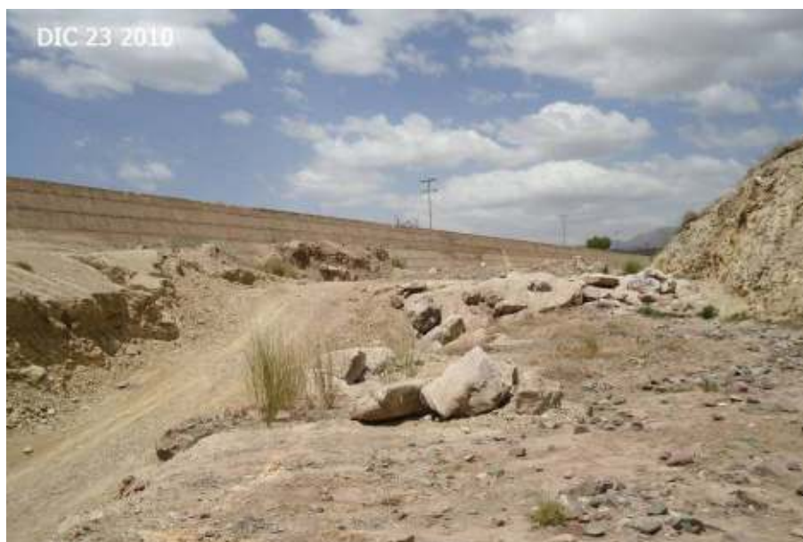
Figura 89: Vista de la estructura del Azud san Isidro hacia aguas arriba, donde la acción de las maquinarias ha tratado de no alterar el escalón de fondo que mantiene evita el avance de la erosión regresiva del cauce sobre las estructuras hidráulicas.
