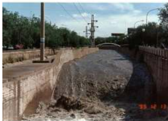
Figura 126: Crecida en el tramo aguas arriba de la desembocadura del Zanjón Frías, en el salto inmediatamente aguas arriba de la desembocadura del mismo.
