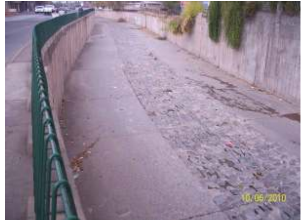
Figura 246: Detalle hacia aguas abajo de la solera y de la sinuosidad a que se ve sometida la traza para seguir los contornos urbanos.
