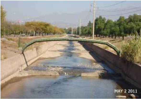
Figura 157: Sección típica del Canal Cacique Guaymallén de 15 m de ancho y 3 m de altura
