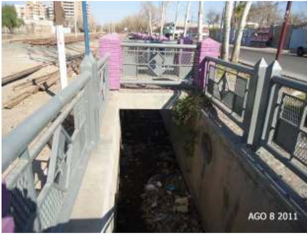
Figura 392: Alcantarilla típica del Colector paralelo a calle Segura en Godoy Cruz, en la zona de vías.
