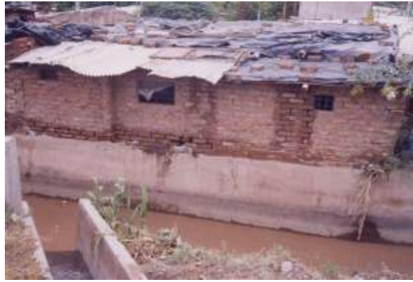
Figura 308: Desborde del Canal Jarillal sobre la margen derecha, en un sector de viviendas precarias.
