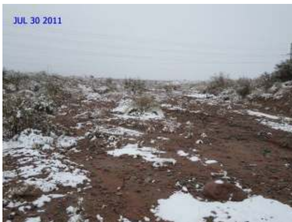
Figura 414: Vista hacia aguas arriba donde el colector no tiene las márgenes revestidas
