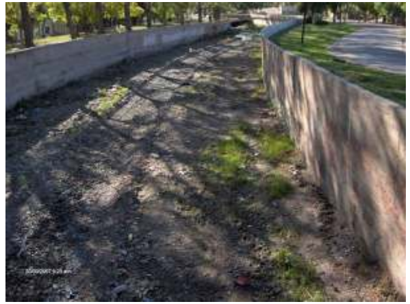
Figura 221: Detalle del material de fondo. Se trata de un material eminentemente grueso. Al final, puede verse uno de los tantos dientes de estabilización de fondo, para disminuir la pendiente de la solera.
