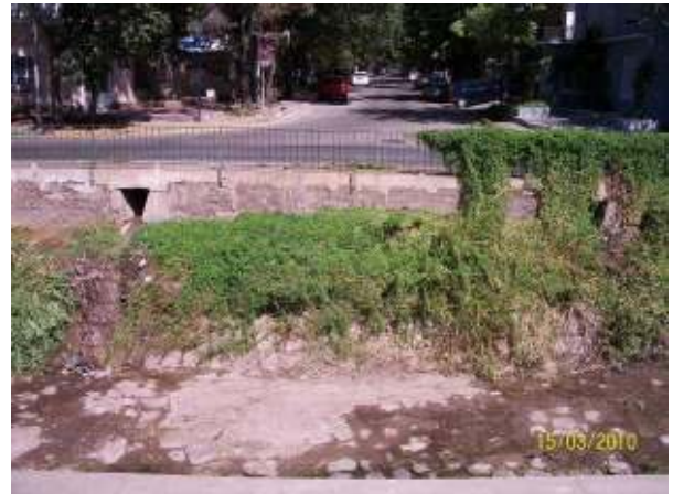
Figura 383: Desagües clásicos de las acequias sobre la infraestructura de conducción, en este caso el Zanjón Frías, a la altura de la Casa de Gobierno.
