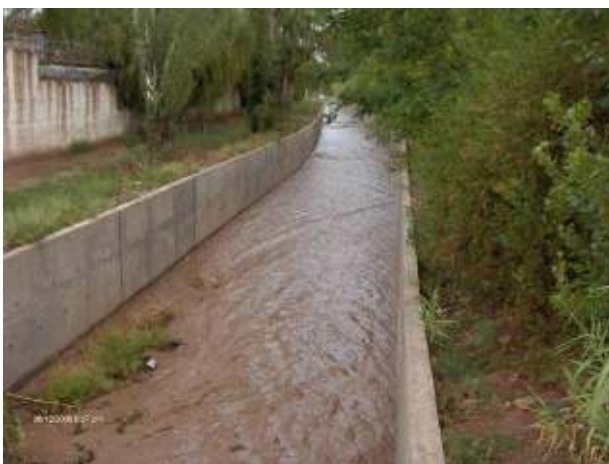
Figura 198: Descarga aluvional a través del cauce revestido del Río Seco Viamonte
