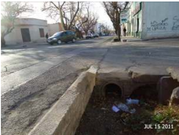
Figura 378: Acequia sin revestir. Ejemplo de la falta de infraestructura de conducción que favorece la acumulación de RSU. La pendiente de fondo no posee valores aceptables para un buen escurrimiento de las dotaciones y del agua pluvial urbana.
