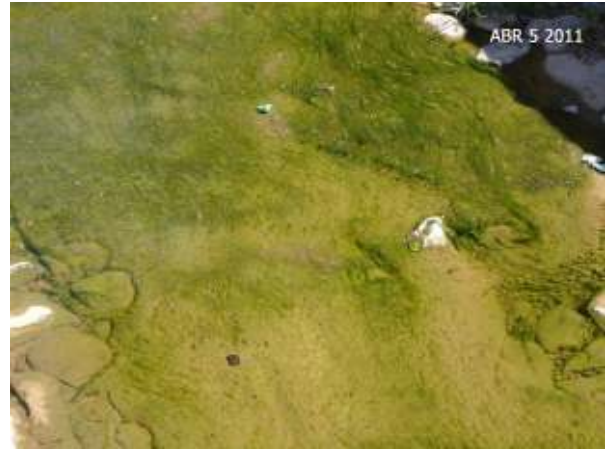
Figura 381: Detalle de la solera del Zanjón Frías con el desarrollo de lama debido a la permanencia del agua proveniente de los desagües de acequias y de los canales de riego que lo atraviesan (Canales Civit, del Oeste y Jarillal).
