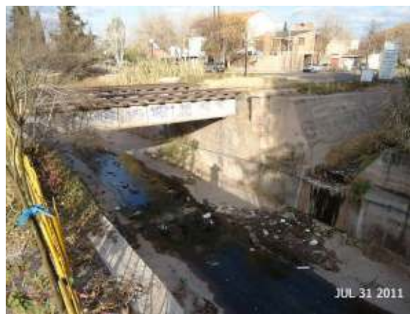
Figura 277: Sección del Zanjón de Los Ciruelos a la altura del Puente del Ferrocarril y Calle Perú. Puede observarse la incorporación de un importante canal de desagüe pluvial urbano.
