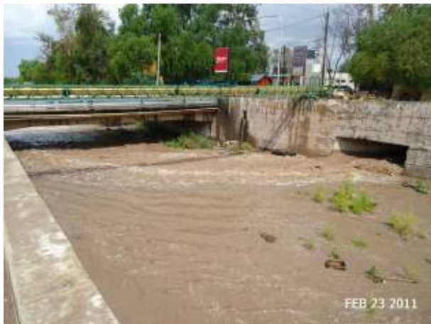
Figura 334: Descarga aluvional del Colector Gorriti sobre el cauce del Zanjón Frías.
