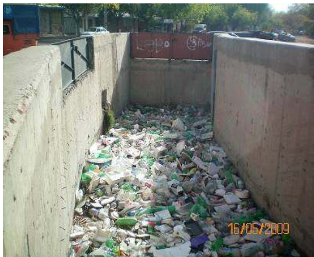
Figura 239: Acumulación de RSU en la cámara de carga del sifón del Canal del Oeste, aguas abajo del Canal Jarillal, en su intersección con la calle Gorriti
