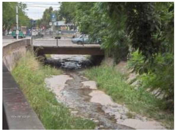
Figura 260: Sección aguas arriba del puente de calle Nueve de Julio, con el fondo del puente de Avenida General San Martín. Cuando el puente funciona como orificio, la carga aguas arriba aumenta y se producen desbordes por encima de las barandas. Estas estructuras, normalmente se tapan inmediatamente con el arrastre superficial y suelen sufrir el empuje del agua, con frecuentes fracturas de sus anclajes o deformaciones en su plano.
