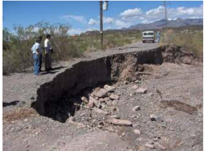
Figura 79: Socavón en el Terraplén del Azud San Isidro. Solamente faltaron unos pocos centímetros para que la crecida se dirigiera hacia el Gran Mendoza.
