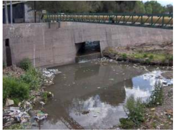
Figura 333: Desembocadura del canal Gorriti en el Caci que Guaymallén. La basura, los desperdicios y la constante presencia del agua de desagüe toman de complicado manejo el entorno, ya que los mismos vecinos y la municipalidad reclaman por la limpieza de elementos que provienen de la misma jurisdicción.
