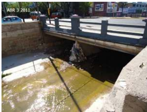
Figura 228: Restos de RSU arrastrados por la crecida del 23 de febrero de 2011 en el puente San Martín.
