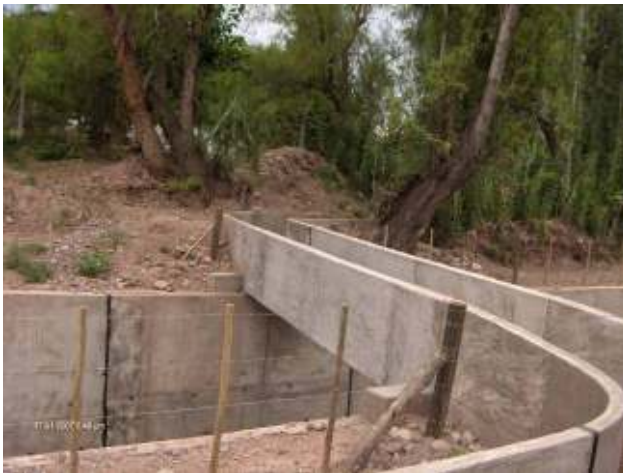
Figura 190: Puente canal con la nueva traza de la hijuela de riego Chacras de Coria
