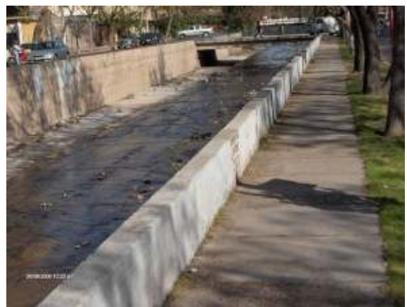
Figura 225: Revestimiento del cauce, aguas arriba de la Calle San Martín. Al fondo, el puente de calle Fray Luis Beltrán.
