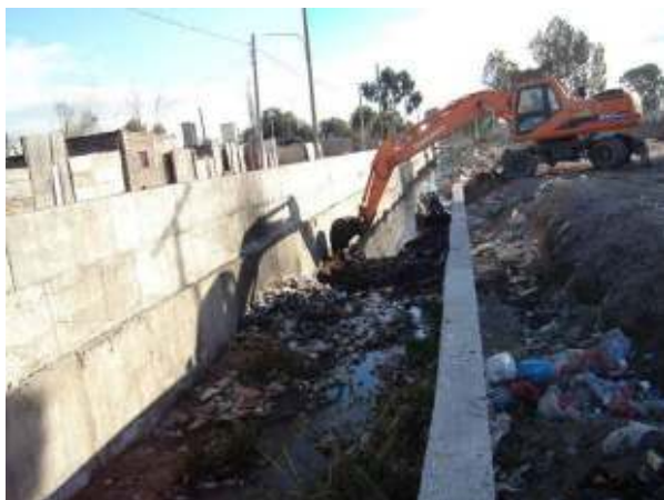
Figura 290: Maquinaria propia de la Dirección de Hidráulica efectuando una de las habituales limpiezas del colector
