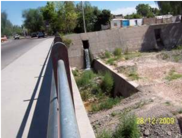
Figura 382: Desagüe de acequia de arbolado público sobre el Zanjón Frías, proveniente de la red de Godoy Cruz.
