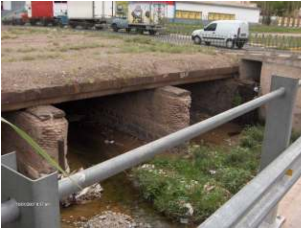
Figura 253: Clásica imagen del Zanjón Frías en su intersección con la vía principal del Ferrocarril General San Martín, cien metros aguas arriba del cambio de dirección hacia el norte. Puede verse la desembocadura del colector ejecutado por la Municipalidad de Godoy Cruz en la zona de vías, paralelo a la calle Pedro Pascual Segura de ese departamento.
