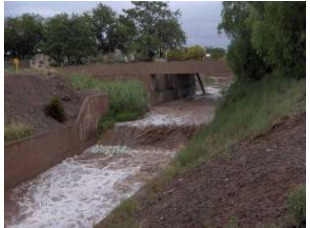
Figura 267: Sección rectangular típica del Zanjón de Los Ciruelos durante un escurrimiento pluvioaluvional. Puede observarse la gran cantidad de botellas plásticas que han quedado atrapadas en el vórtice del resalto.
