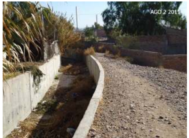
Figura 299: Estado del colector revestido en la antigua zona más vulnerable.
