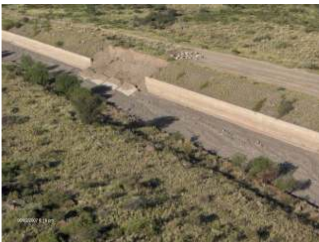
Figura 432: Visa aérea de la caída de los tres muros de sostenimiento por falta de nivel de sustentación en la fundación, causado por la erosión del pie de las estructuras.
