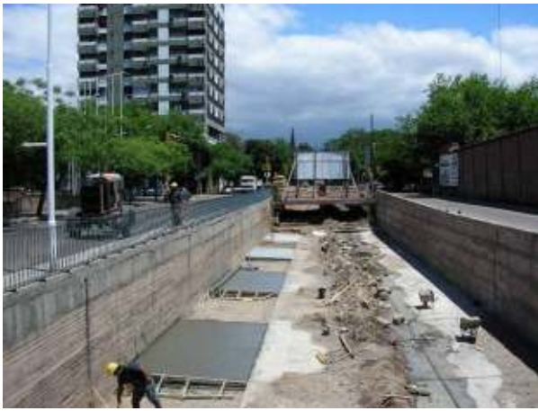
Figura 226: Etapa de revestimiento de las soleras del cauce, entre calle San Martín, al fondo, y calle Belgrano (I Etapa)
