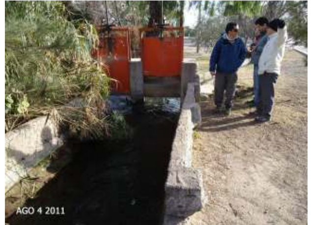
Figura 341: Compuertas Canal Civit aguas arriba del sifón que pasa por debajo del Zanjón Frías.
