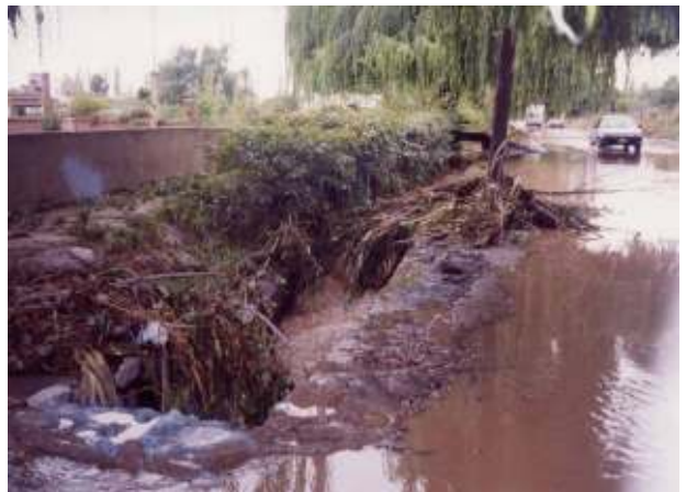
Figura 403: Estado del desagüe e hijuela, ambos de riego, después de una tormenta convectiva. El desagüe corresponde al que se encuentra entre calle Longone y Medrano
