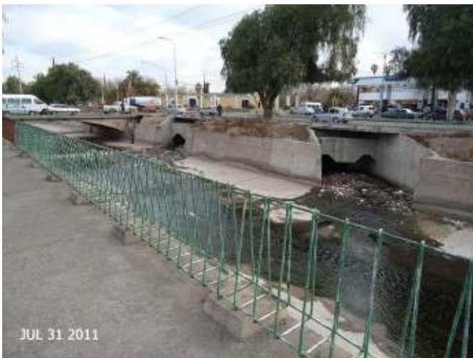
Figura 394: Desembocadura directa del Sistema de desagües pluviales de la plaza Pedro del Castillo directamente en el Canal Cacique Guaymallén
