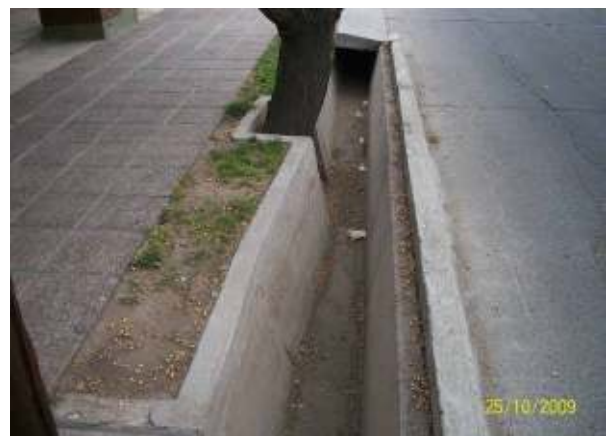
Figura 366: Morera híbrida de fuste importante, que ha comenzado a afectar el cauce de la acequia, estrangulando su sección transversal. Puede observarse que el estrangulamiento comienza a producirse a pesar que el árbol se encuentra su nivel de implante en coincidencia con la solera de la acequia.
