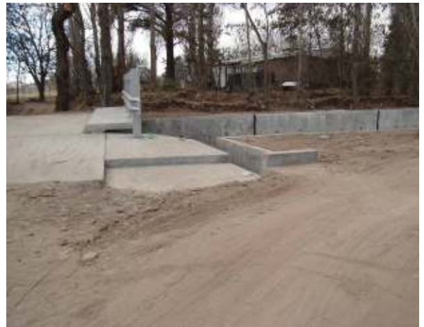
Figura 170: Detalle de la desembocadura de los drenajes de Calle Orsini, la cual posee uno a cada costado,
