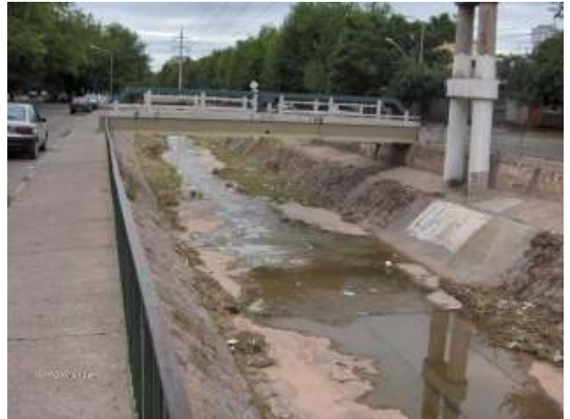
Figura 258: Cauce en dirección oeste – este. La línea de alta tensión se encuentra fundada en la franja del cauce. Cruce peatonal correctamente realizado, sin interceptar el área hidráulica de escurrimiento.
