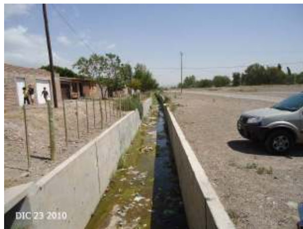
Figura 362: Tramo revestido aguas abajo de calle Diamante, colindante con el B° SMATA.
