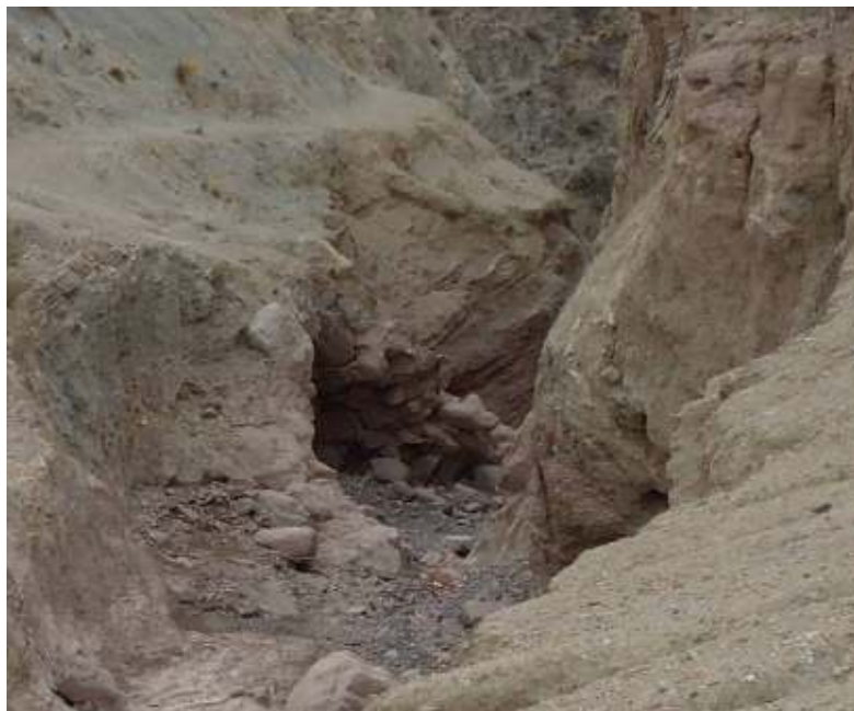
Figura 95: Estado del pedraplén de contención aguas abajo de la Garganta del Diablo
