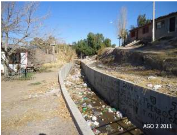
Figura 298: Estado del colector revestido aguas arriba de la primer pasarela
