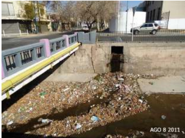
Figura 385: Desembocadura de uno de los colectores pluviales del sistema de la plaza de Godoy Cruz en calle Colón.
