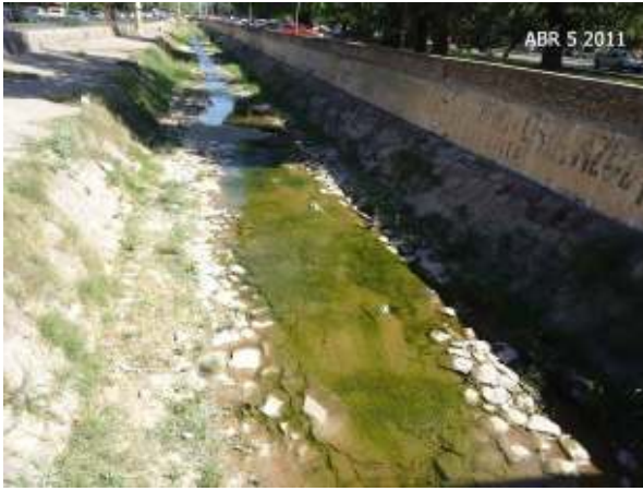
Figura 380: los Frecuentes desagües sobre el cauce de la infraestructura de conducción de crecidas pluvioaluvionales. La permanencia del agua favorece el desarrollo vegetativo y de la lama debido al agua clara.
