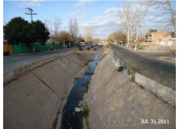
Figura 283: Sección Trapezoidal típica del Zanjón de los Ciruelos hasta la desembocadura en el Canal Caciue Guaymallén.
