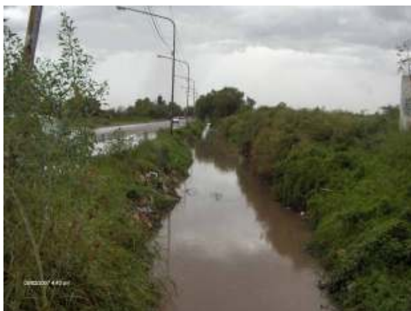
Figura 359: Imagen de la sección sin revestir del Colector, aguas arriba de la calle Río Diamante, antes de ingresar al conglomerado urbano que se conoce como Barrio Municipal. El primer barrio es el SMATA. Puede verse inmediatamente que la pendiente del colector es prácticamente nula en este tramo.
