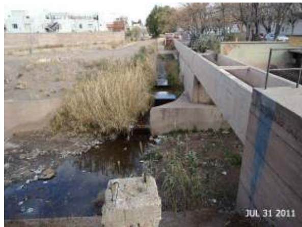
Figura 274: Descargador del Canal Jarillal al Zanjón de Los Ciruelos. Puede observarse la canaleta que sobrepasa el cauce aluvional como puente canal, reduciendo su sección transversal.
