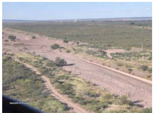
Figura 433: Vista aérea del Colector Las Heras embancado a la altura del badén de la Ruta Provincial N°13.
