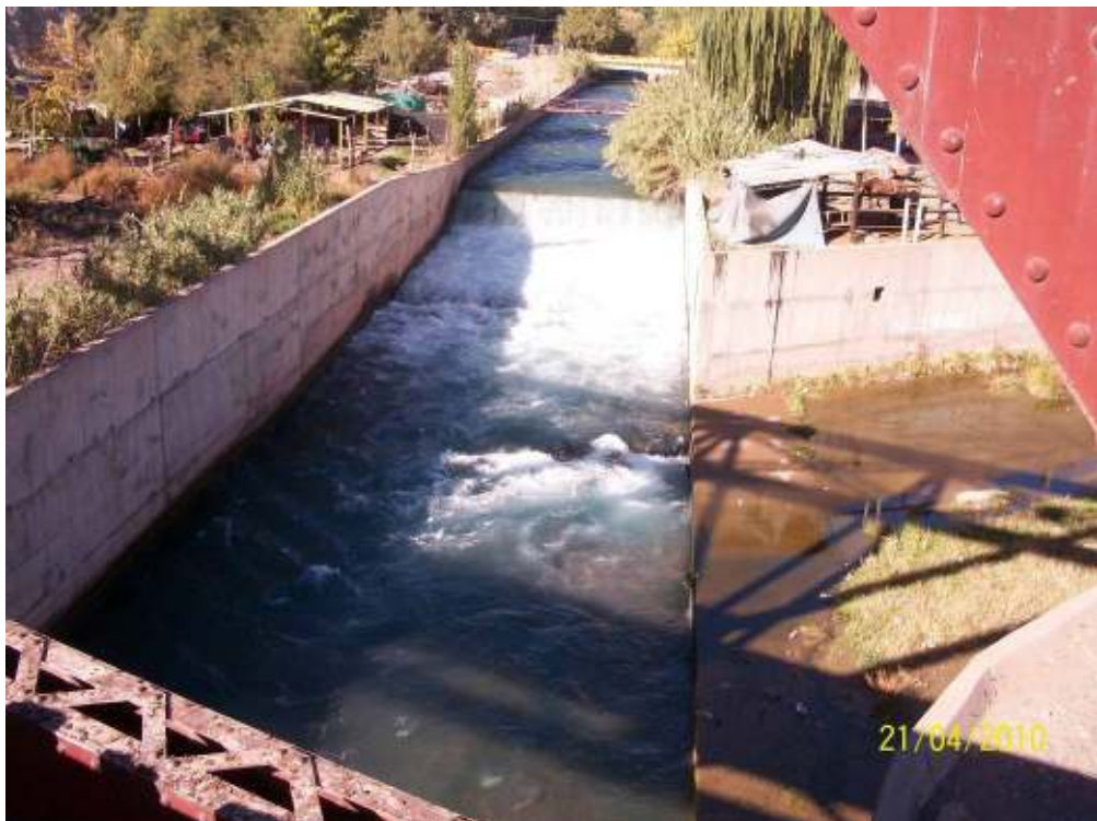
Figura 130: Desembocadura del Zanjón Sosa sobre el cauce del Canal Cacique Guaymallén, el que presenta un salto con cuenco amortiguador previa a la desembocadura
