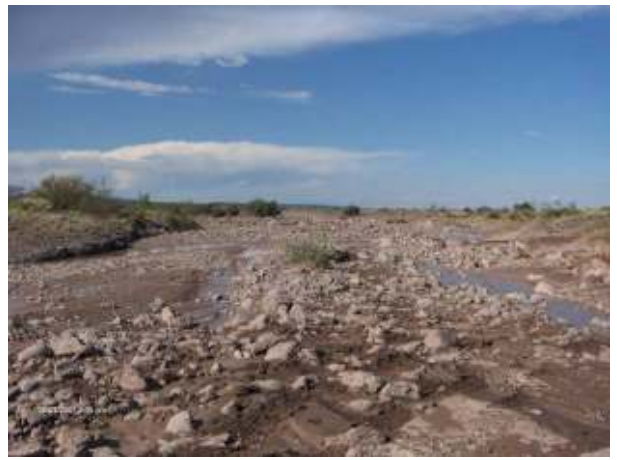
Figura 437: Vista hacia aguas abajo del badén de la Ruta Provincial N°13. El cauce del Colector se encontraba totalmente embancado.
