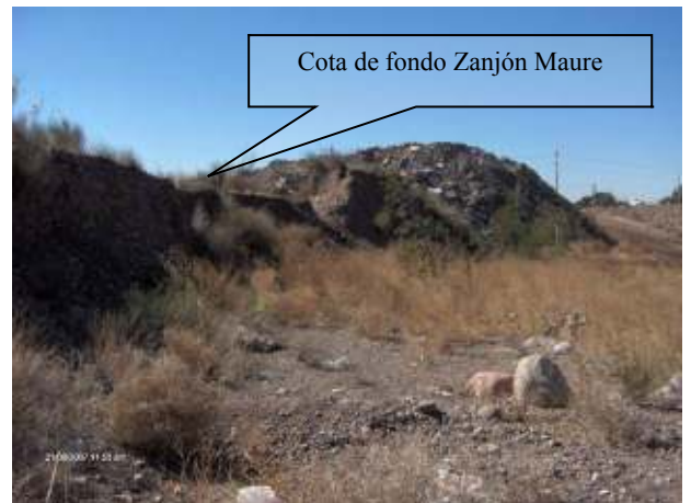
Figura 208: Vista hacia aguas abajo. Sobre la izquierda de la fotografía puede verse el desnivel que existe entre el fondo del cauce y la cota de entrada al foso.
