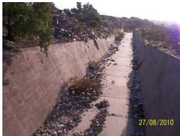
Figura 39: Canal de evacuación en su situación actual, con asentamientos sobre su margen izquierda
