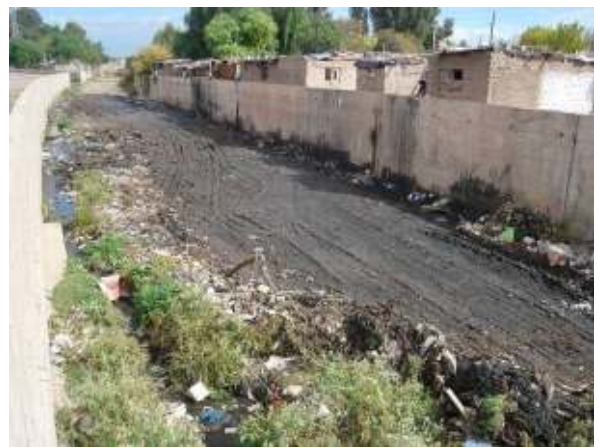
Figura 212: Imagen en la campaña de otoño de 2007, durante los trabajos de limpieza y extracción de residuos. Numerosos son los desagües que desembocan en su cauce, favoreciendo el crecimiento de vegetación y dificultando las tareas de las maquinarias.
