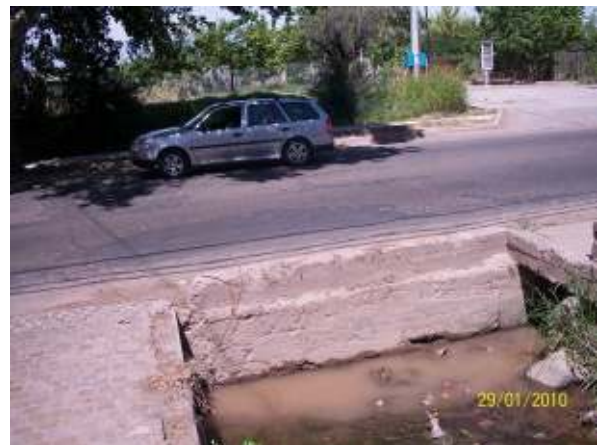
Figura 405: Desagüe entre calle Longone y Medrano, el cual termina a 90° en una acequia de desagüe vial y pasa por una alcantarilla, ambas de mínimas dimensiones hacia la hijuela Chacras de Coria, que se encuentra al otro costado de calle Viamonte.
