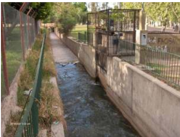
Figura 328: Obra de control aguas arriba de la desembocadura del Gorriti en el Frías. El agua corresponde a las dotaciones de riego del Jarillal. Si se acciona la compuerta, el agua desemboca en el Zanjón Frías
