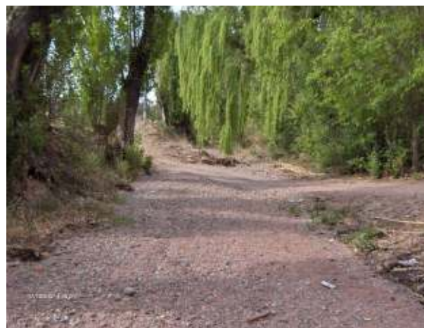
Figura 174: Badén típico sobre el cauce del Río Seco Viamonte, aguas arriba de calle Orsini, favoreciendo claramente el desborde de las descargas aluviales.
