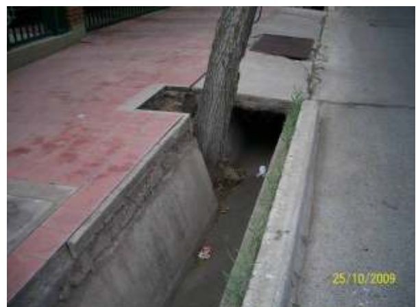
Figura 368: Morera implantada a nivel de la solera de la acequia. La influencia de las construcciones provoca que el árbol tienda a alejarse a través de la inclinación de su fuste obstruyendo parcialmente la sección de escurrimiento.
