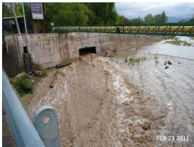
Figura 336: Descarga aluvional del Colector Gorriti sobre el cauce del Zanjón Frías, visto desde aguas abajo
