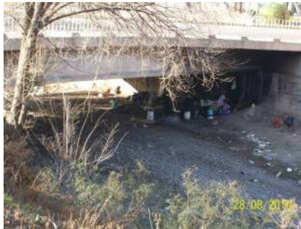
Figura 384: La infraestructura de desagües mayores de la Ciudad de Mendoza suele presentar problemas sociales, tales como la instalación de personas sin hogar, representando un grave riesgo para su seguridad y la de los transeúntes. En la mayor parte de los casos, las autoridades se hacen presentes y proceden al desalojo correspondiente.
