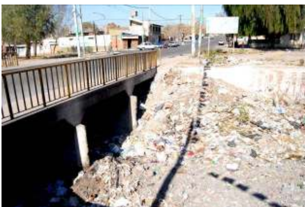
Figura 354: Puente carretero de cruce sobre el cauce. Puede apreciarse la gran cantidad de basura que es arrojada desde las banquetas de la calle.
