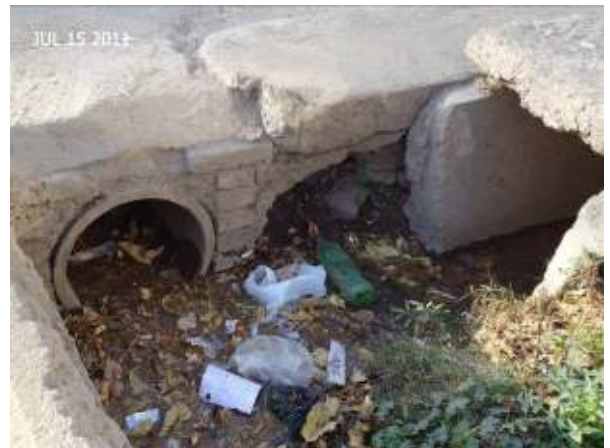
Figura 379: Detalle de una alcantarilla realizada con un caño de hormigón con la consiguiente reducción de la capacidad hidráulica. La falta de pendiente se evidencia por la sedimentación en la propia boca de la rudimentaria alcantarilla.
