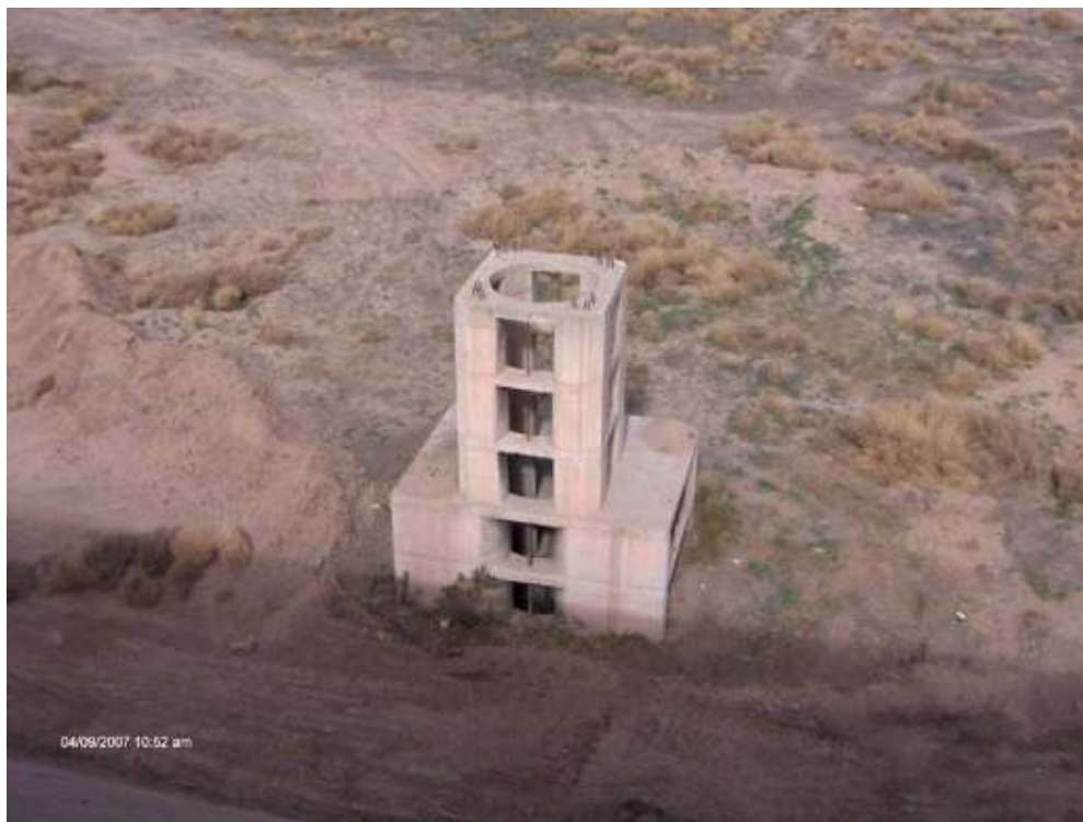
Figura 36: Detalles de la torreta de margen derecha. La sedimentación del vaso se encuentra sobre el nivel del primer orificio de la torreta.
