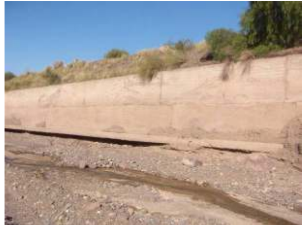
Figura 441: Detalle del descalzamiento del pie de los muros. La carga estática del terraplén superior contribuyó a la falla de los muros de la imagen anterior.
