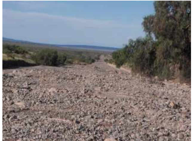
Figura 435: Vista desde el salto triple hacia aguas abajo. El colector se ve totalmente embancado en su tramo de 2500 metros.
