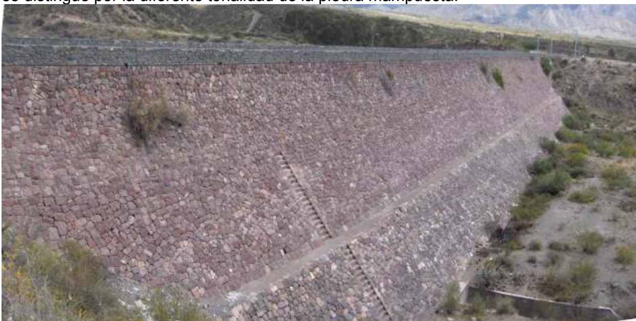
Figura 60: Vista del espaldón aguas abajo y el canal de descarga de la torreta de la margen derecha, El sistema de torretas es similar al del Dique Maure, con dos abocinamientos inferiores para los primeros niveles y orificios protegidos por rejas verticales para el resto (Figura 61 y Figura 62. El orificio superior se encuentra protegido por una rejilla para evitar accidentes, debido a que el lugar es muy frecuentemente visitado como sitio de esparcimiento durante los fines de semana y días feriados.
