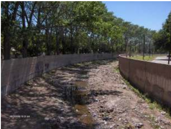
Figura 222: Curva suave del cauce en pleno desarrollo urbano, visto hacia aguas abajo, posteriormente a los trabajos de limpieza que la Dirección de Hidráulica realiza con maquinaria propia.
