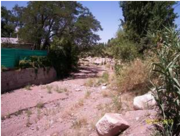
Figura 200: Curva hacia el norte, donde la margen derecha se encuentra en riesgo de desborde, mayor a todo el resto de la traza.
