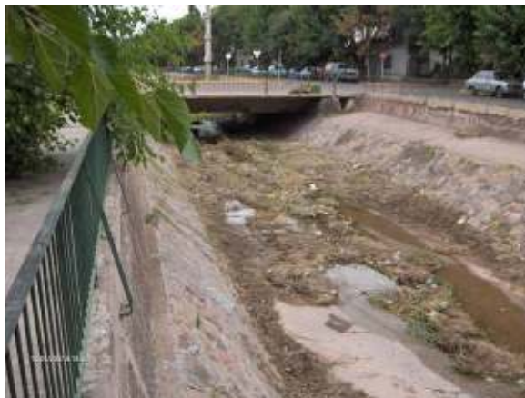
Figura 259: Sección aguas arriba del puente de calle La Pampa, estructura que se interna en el área de escurrimiento del Zanjón. En ocasión de las descargas pluvioaluvionales, el puente intercepta el escurrimiento superficial, y funciona como orificio, con escurrimiento a presión, durante el pico de la descarga, el cual no llega a ser mayor a diez minutos.
