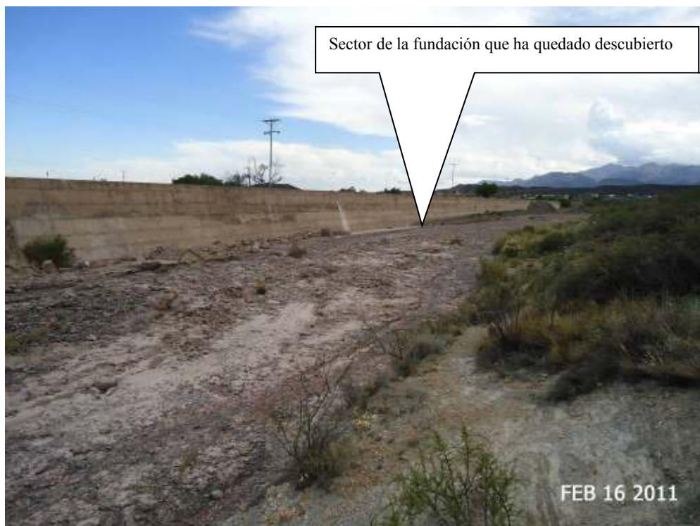
Figura 93: El nivel del cauce se ha mantenido, pero en un pequeño sector del pie de la nueva fundación realizada en febrero de 2007 el material que se encontraba sobre el pie ha sido transportado por las crecidas ocurridas.
