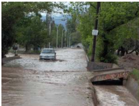
Figura 106: Calle Pueyrredón, aguas arriba de la desembocadura del Río Seco Sosa, en funcionamiento como calle canal, luego de una precipitación acompañada de granizo.
