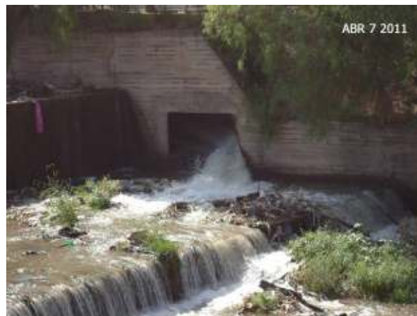
Figura 236: Detalle del vuelco del agua de riego y limpieza del Jarillal sobre el Zanjón Frías.
