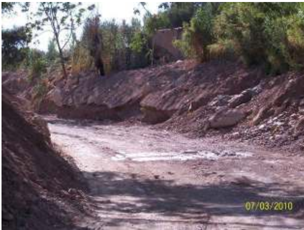
Figura 202: Trabajos de excavación para la solera del canal en plena temporada estival
