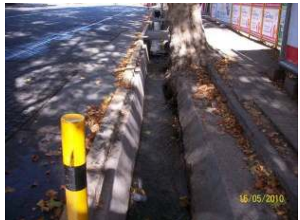
Figura 374: El revestimiento de las acequias suele ser reemplazado por hormigón en sectores de piedra, dejando en el fondo un tramo para la absorción por parte del árbol, caso de un gran plátano, que comienza a obstruir la sección hidráulica y levantar la vereda.
