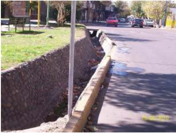
Figura 375: Acequia revestida en piedra, de reciente realización, que recibe el abastecimiento de uno de los tantos pozos de agua subterránea que refuerzan la dotación del arbolado público.
