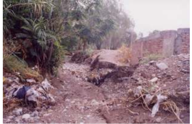
Figura 297: Punto de mayor fragilidad que la Hijuela Chacras de Coria presentaba con su cauce sin revestir. Sobre la Margen izquierda se encuentran los asentamientos precarios.
