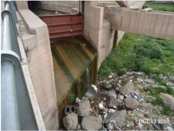
Figura 216: Descargador del Canal Jarillal al Zanjón Maure con alguna deficiencia de estanqueidad, durante su funcionamiento normal
