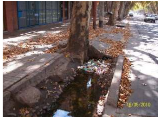
Figura 372: Acequia revestida en piedra bola que ha perdido parcialmente su revestimiento con el paso de los años. El gran fuste del plátano obstruye parcialmente con su sistema radicular la sección hidráulica, en coincidencia con la entrada de un puente vehicular. Esta situación es muy común en todo el sistema.
