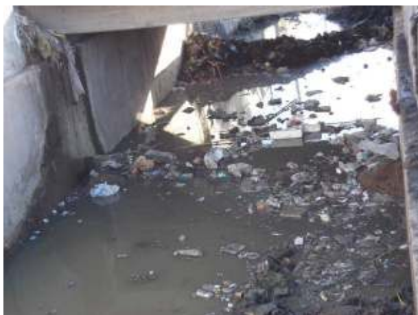
Figura 292: Detalle del estado del cauce del colector con el agua de los desagües urbanos, combinado con los residuos y el material de arrastre acumulado.
