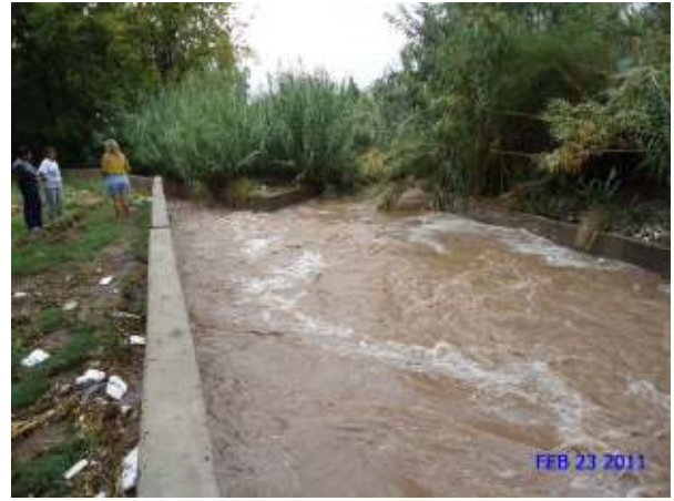
Figura 303: Desembocadura de la Hijuela Chacras de Coria en el Canal Jarillal durante una crecida aluvional. De acuerdo a testimonios de vecinos, el lugar fue objeto de un desborde en coincidencia de la unión de ambos canales
