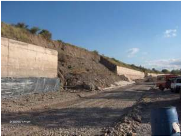
Figura 440: Falla de tres muros a causa de la erosión sobre el pie que los descalzó completamente.
