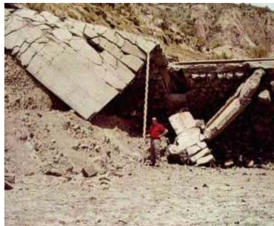
Figura 47: Relevamiento realizado durante el estudio de las causas de la rotura del Dique Frías
