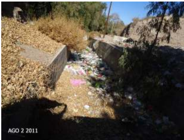
Figura 309: Estado del Cauce revestido aguas arriba del cruce del Canal Civit, con gran cantidad de RSU que son arrastrados por las crecidas.
