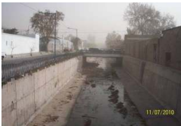
Figura 232: Imagen desde aguas abajo del III Tramo, entre calles Balcarce y Tomba, durante la ocurrencia del viento Zonda.
