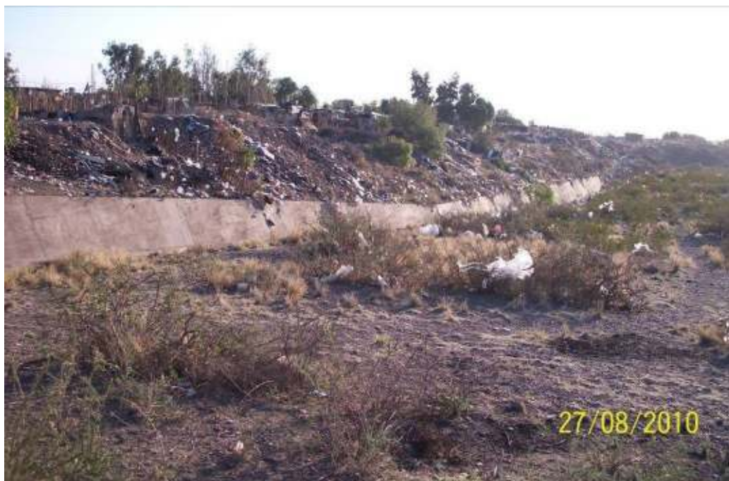
Figura 40: Ocupación de la margen izquierda del Canal de Evacuación del Aliviadero
