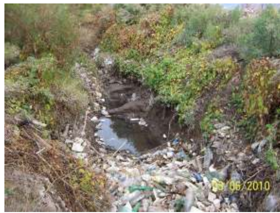
Figura 399: Estado del cauce del Canal Moyano aguas abajo, hacia el norte del Parque Industrial Eje Norte de Las Heras, Etapa I
