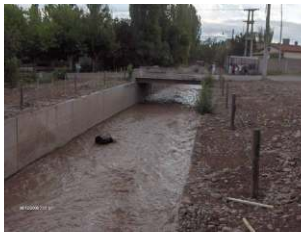
Figura 199: Caudales de crecida en el Río Seco Viamonte aguas abajo del puente de calle Ugarte.
