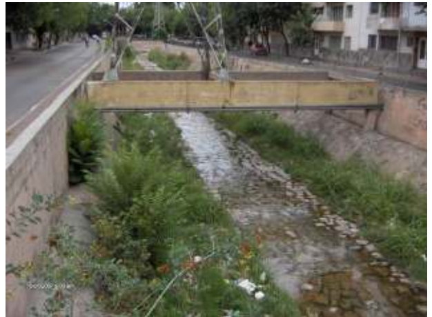
Figura 256: Detalle del tramo antes mencionado, donde se puede apreciar las interferencias entre la infraestructura de circulación, de evacuación pluvial y la de transporte eléctrico de alta tensión. La coexistencia en una angosta franja de terreno crea conflictos de difícil resolución.
