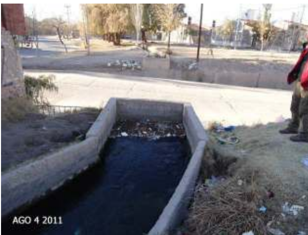
Figura 350: Vista del Sifón de cruce del Canal Civit bajo el nudo de calle Gorriti. Puede observarse la cantidad de RSU
