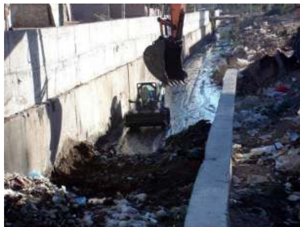
Figura 291: Detalle del trabajo conjunto una minicargadora y una excavadora hidráulica sobre neumáticos de 20 toneladas.
