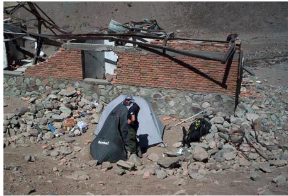
Figura 4: Refugio destruido en campamento Colombia (Fuente: Moreiras, 2008 ).
