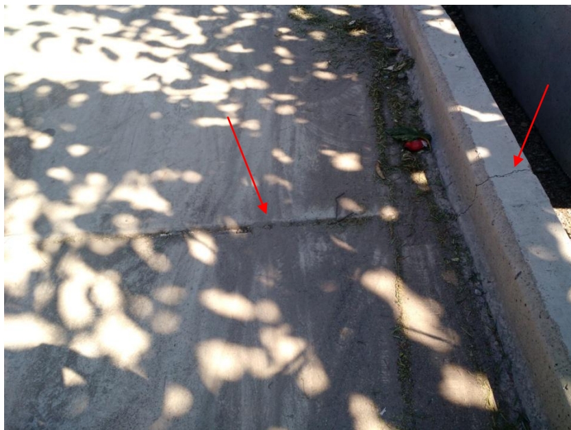
Figura 38 –Falta la realización de barbacana
