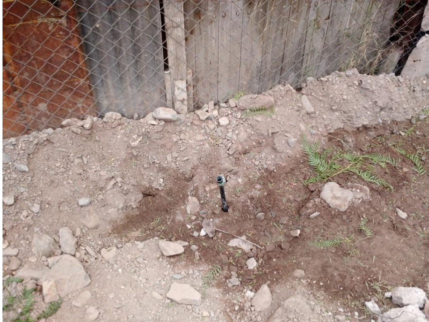
Figura 32 – Acometida que se debe tapar para la realización de la prueba hidráulica.
