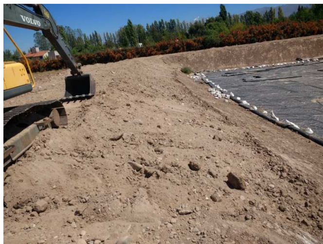
Figura 16. Movimiento de talud.
