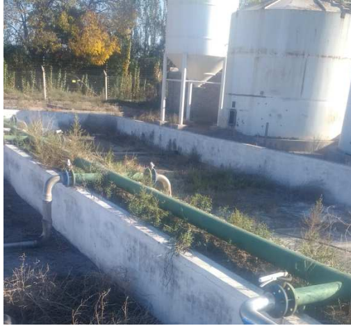
Figura 33. Piletas de secado de lodos.
